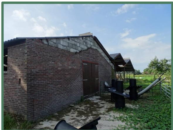
Achteraanzicht beschadigde wand open veldschuur
