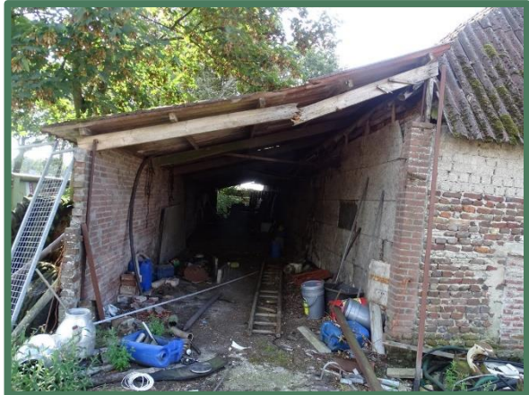
Overzicht verzakkende aanbouw oude schuur
