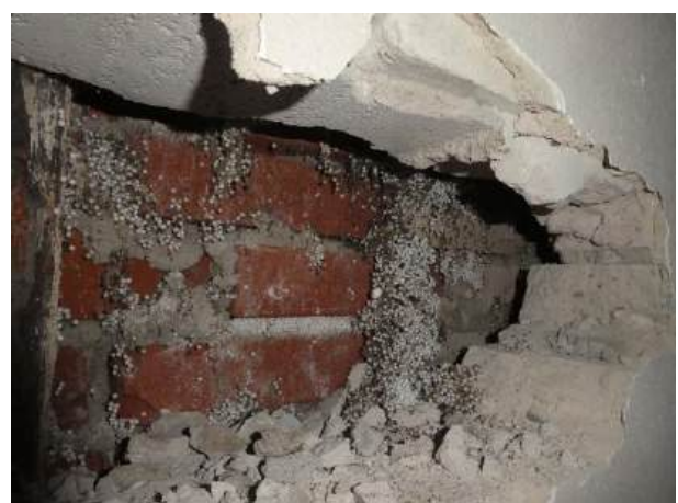
Figuur 12 foto van een gat dat naar de spouwmuur leidt. Het gat dat tot de spouwmuur leidt zit aan de binnen kant van het gebouw.
