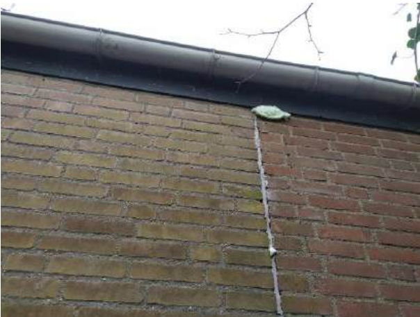
Figuur 9 purschuim vult gaten in de buitenmuur op.
